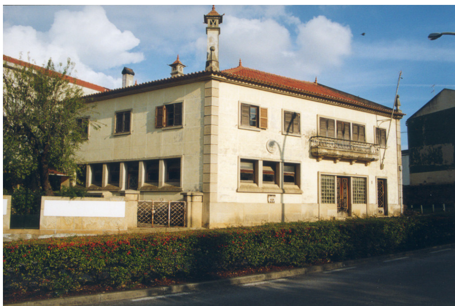
FOTO 4 – Antigo edifício dos CTT, encontra-se num estado de grande degradação.
